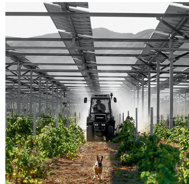
Photovoltaikpaneele über den Weinbergen installiert, Tresserre (Pyrénées Orientales) © Sun'Agri
